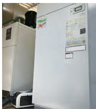
After 複数台分を集約し作業場外に設置
