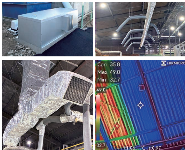
上) 地中熱ヒートポンプ空調設備 下) 各拠点での省エネ対策
